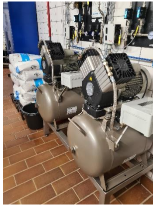
Kompressor til iltning af filtre Der er er kulfilter og mikrofilter på begge trykluft kompressorer.
